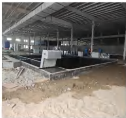
3#厂房污水处理设施 1
